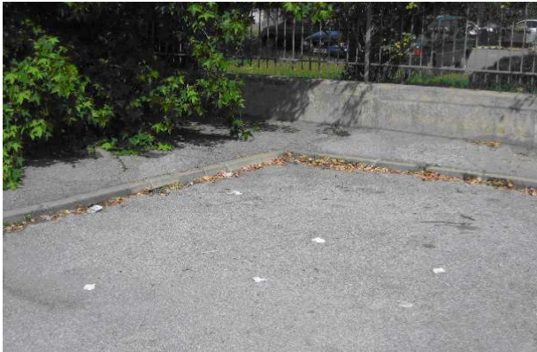
Fig. 9 – Livello di spazzamento insufficiente
